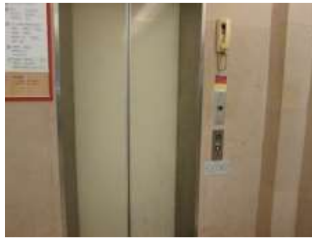
無障礙電梯 3 部
