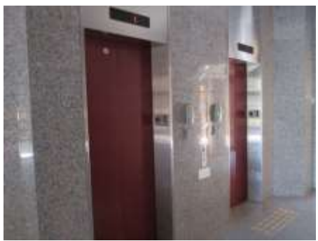
無障礙電梯 2 部
